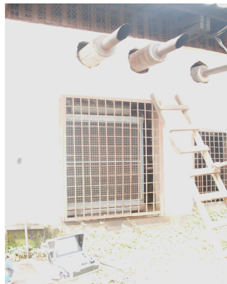
La cheminée du groupe électrogène.
